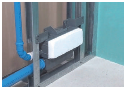
Aplicação em calha técnica
