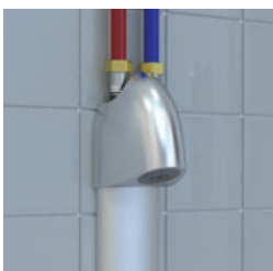
Entradas de água visíveis
